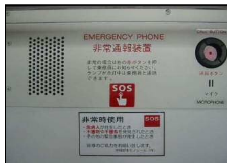
非常通報装置
