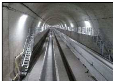
トンネル内避難通路
