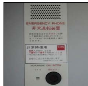
車両連結部 非常通報装置
