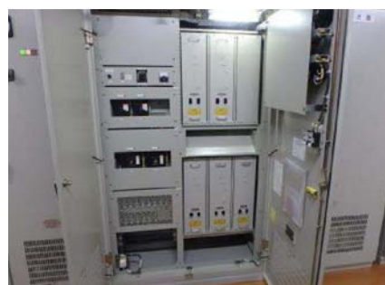
直流電源装置
