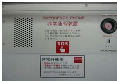
車椅子スペース部 非常通報装置
