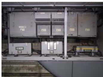
補助電源装置（SIV 装置）
