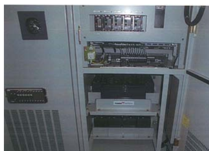
直流電源装置
