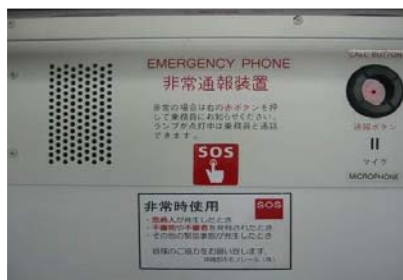
車椅子スペース部 非常通報装置
