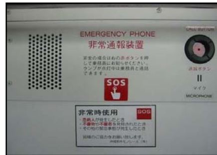
非常通報装置
