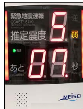
緊急地震速報機器
