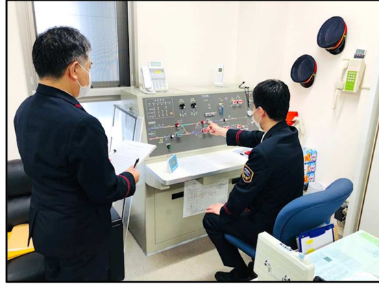
継電連動盤取扱い訓練 (駅)
